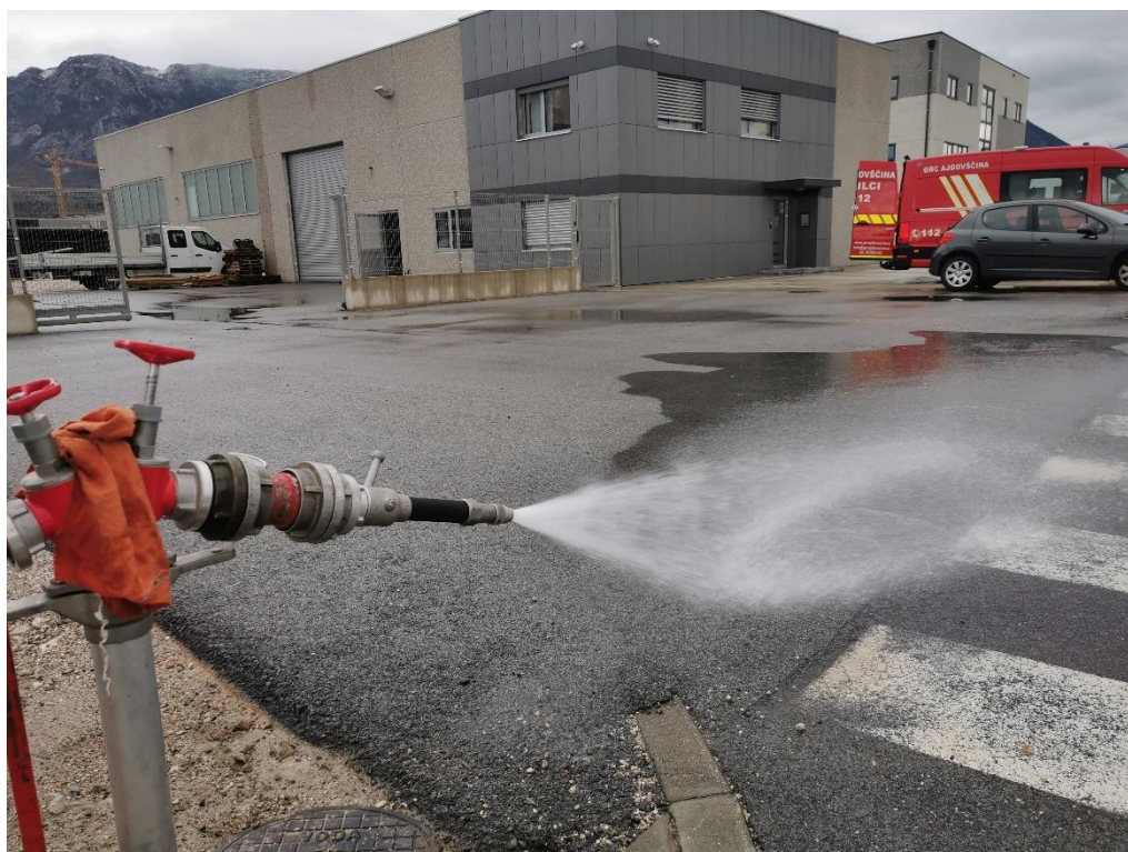
Slika 26: Meritev tlaka hidrantnega omrežja.
