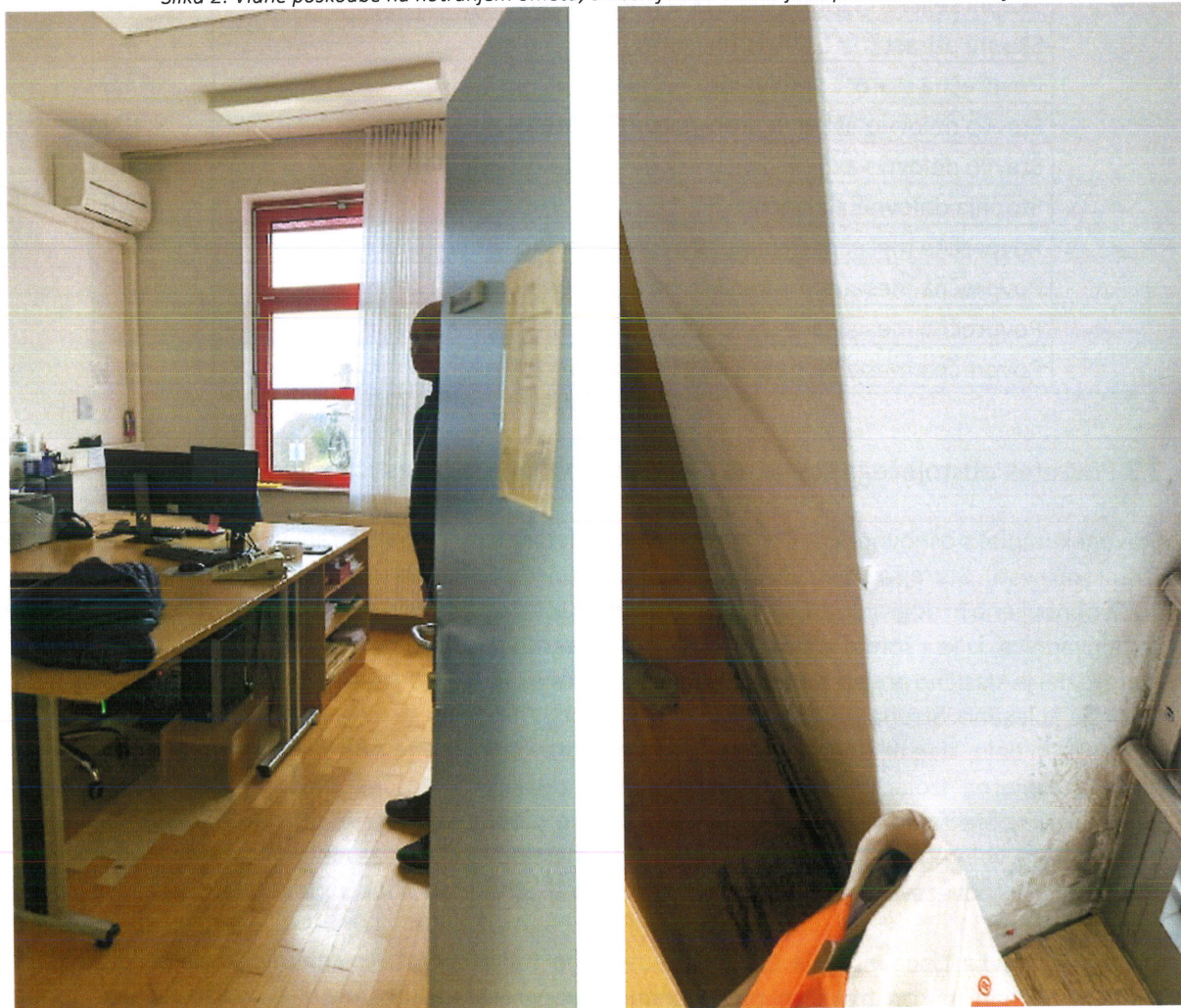
Slika 2: Vidne poškodbe na notranjem ometu, uničen finalni tlak se je že predhodno zamenjal
