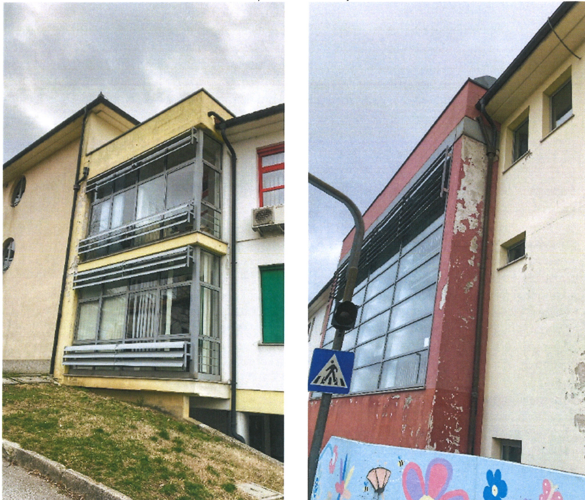
Slika 3: Vidne poškodbe na zunanjem ometu
