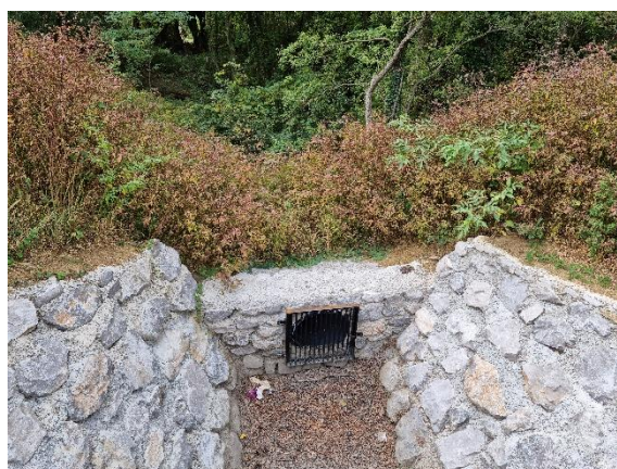
Slika 15: Odvodnik padavinske vode (Matrika ZVO, 2023)
